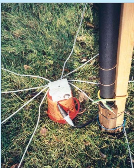
Bild 50: Fußpunkt einer Groundplane-Antenne mit erdaufliegenden Radials; acht – wie hier gezeigt – sind als Minimum anzusehen, 20 oder mehr sind anzustreben. Foto: Red. FA
