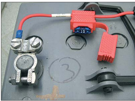
Bild 4: Akkumulatorabsicherung mit einer Flachstecksicherung aus dem Kfz-Bereich
